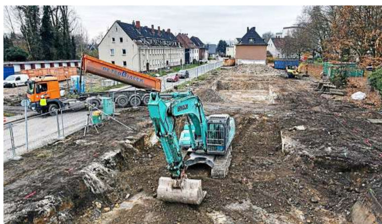
Am Westbach: Nach dem Abbruch stehen Bohrungen für die Geothermie an, danach geht es an den Rohbau. FOTO: WHS
